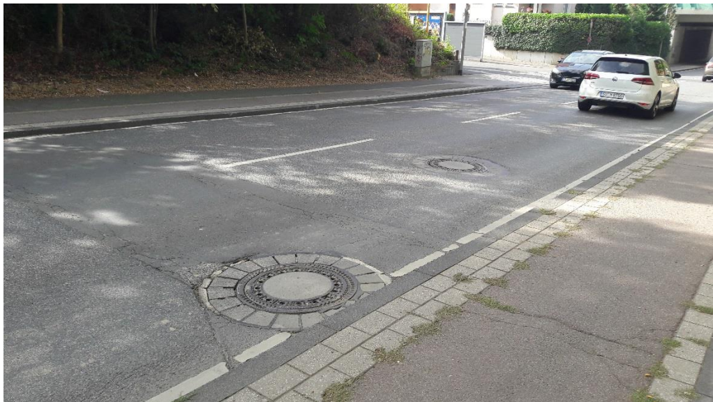
Bild 10: Beispiel Fahrbahnzustand am Schachtdeckel mit Rissen im Radweg
