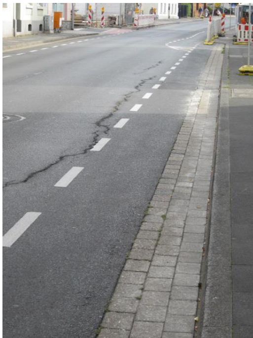
Bild 4: Beispiel Längsriss in Fahrbahn
