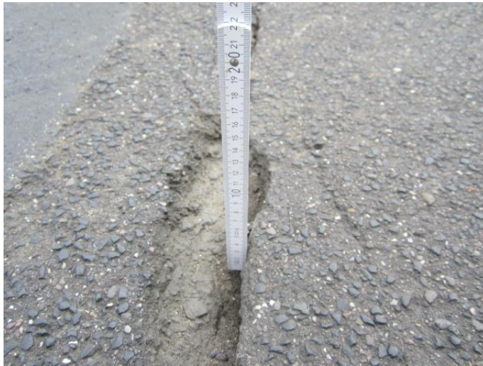
Bild 4: Beispiel Riss in Fahrbahn (mehrere Zentimeter)
