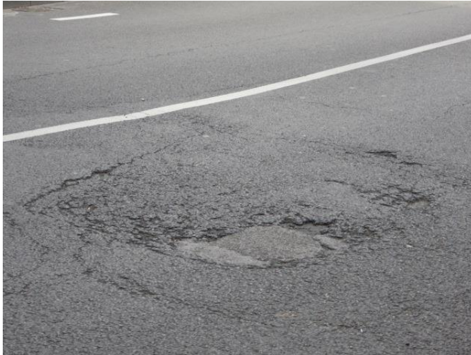
Bild 3: Beispiel abgesackte Decke im Ausbauabschnitt
