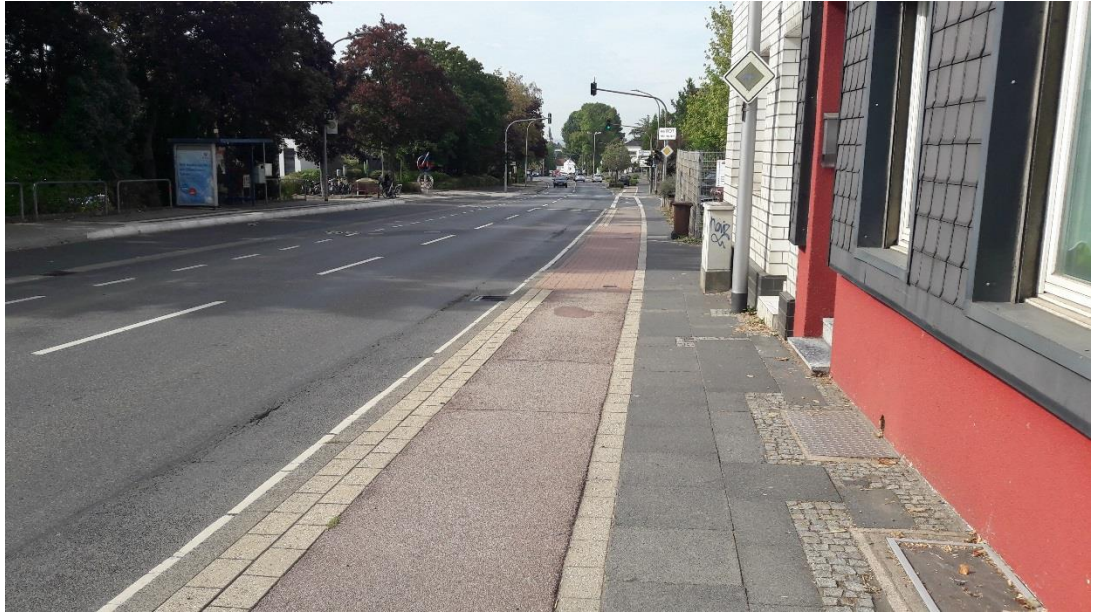
Bild 8: Ausbauabschnitt Am Stadion bis Seidenbergstraße mit Längsriß
