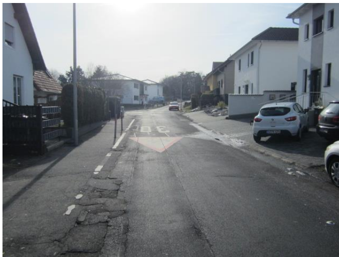
Bild 1: Allgemeinzustand Fahrbahn mit Rissen sowie Pfützen
