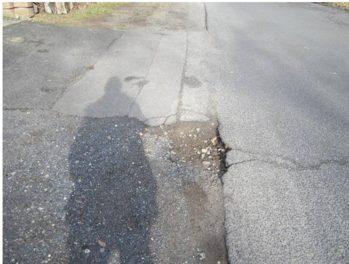
Bild 3: Ausspülungen in Randbereichen
