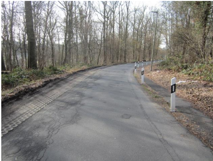
Bild 6: Überfahrene unbefestigte Randbereiche
