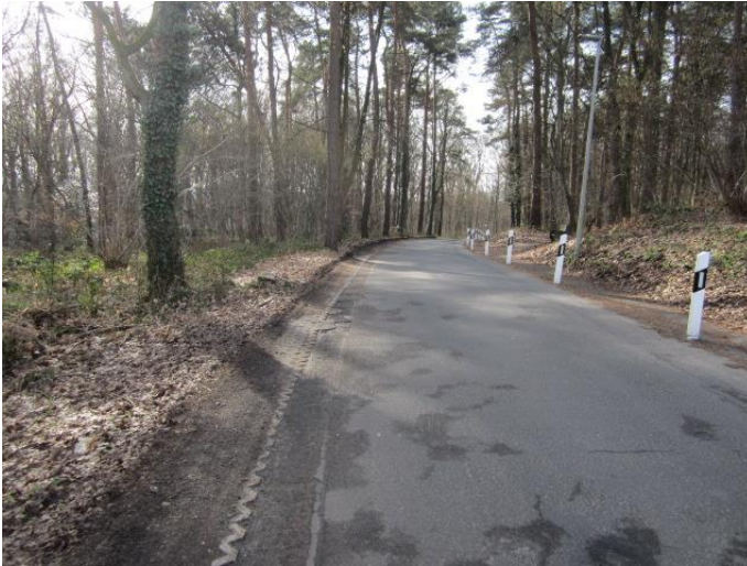
Bild 4 „zusätzliche Rasengittersteine neben Fahrbahn und Leitpfosten als Abgrenzung für Fußgänger“
