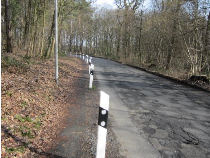
Bild 5: Zustand der Fahrbahn
