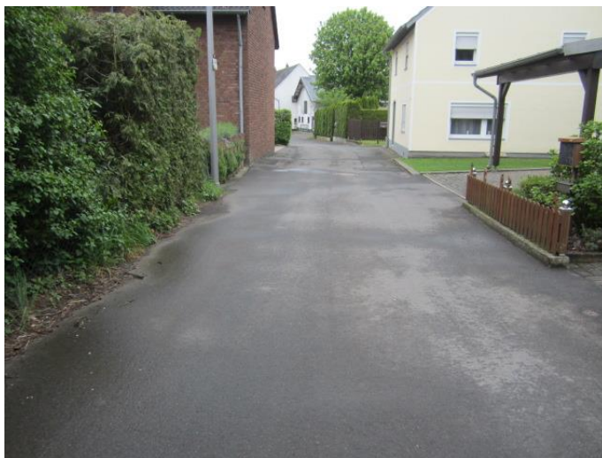
Bild 1: Allgemeinzustand. Übergang neue Decke zum Altbestand
