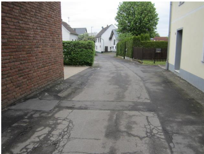
Bild 3: Zustand der Decke
