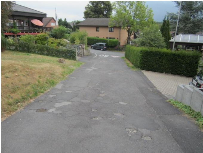
Bild 2 „Straßenzustand nahe Einmündung Lerchenweg“
