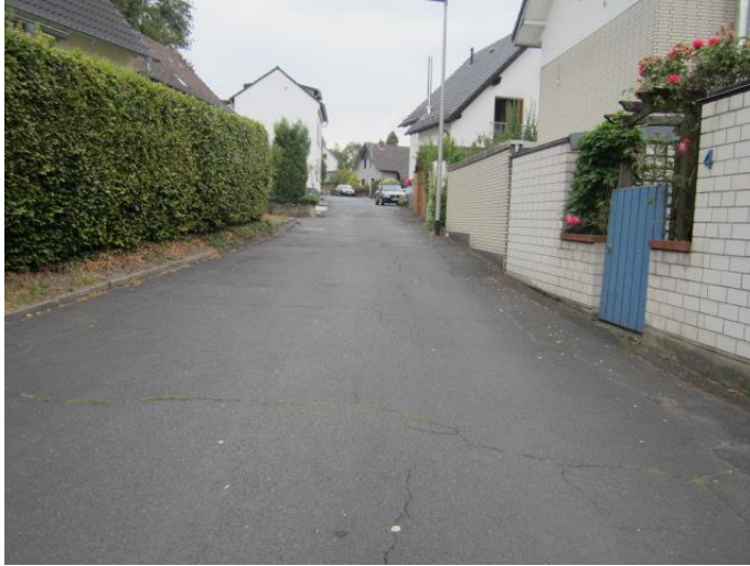
Bild 1 „Straßenzustand nahe Einmündung Jakobstraße“
