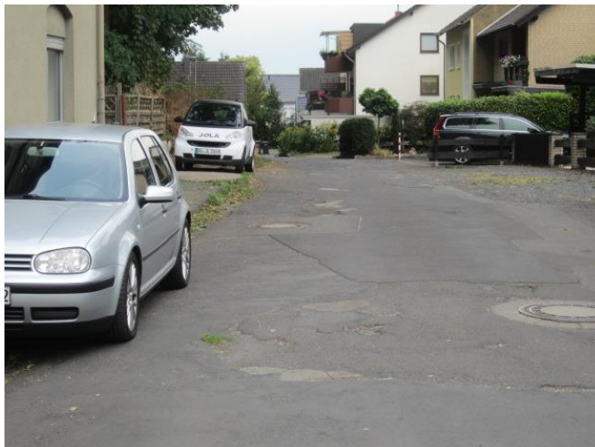
Bild 3: Straßenzustand nördlicher Abschnitt Hubertusweg
