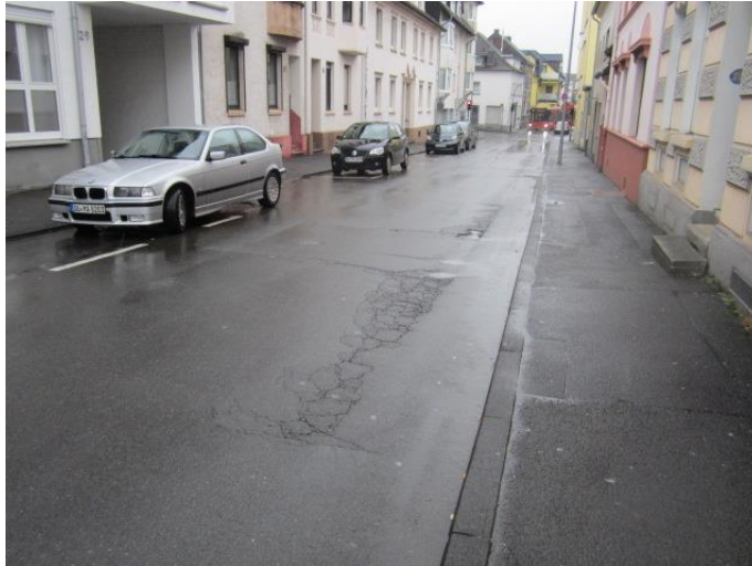
Bild 12: Rissbildung Fahrbahn mit Gehweg
