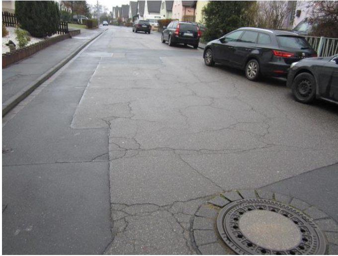
Bild 2: Allgemeinzustand Fahrbahn mit vielen Netzrissen
