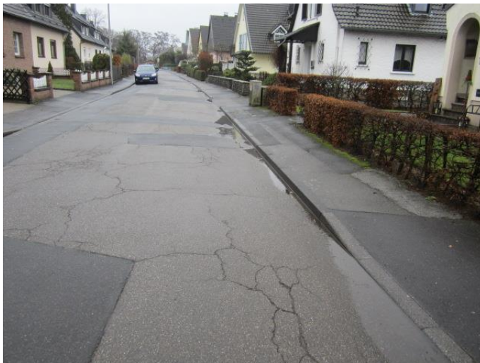
Bild 3: Zustand Gehweg//Fahrbahn mit Pfützenbildung am Rand
