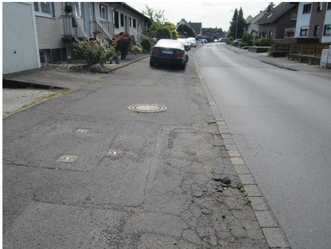
Bild 5: Zustand Nebenflächen und Fahrbahn
