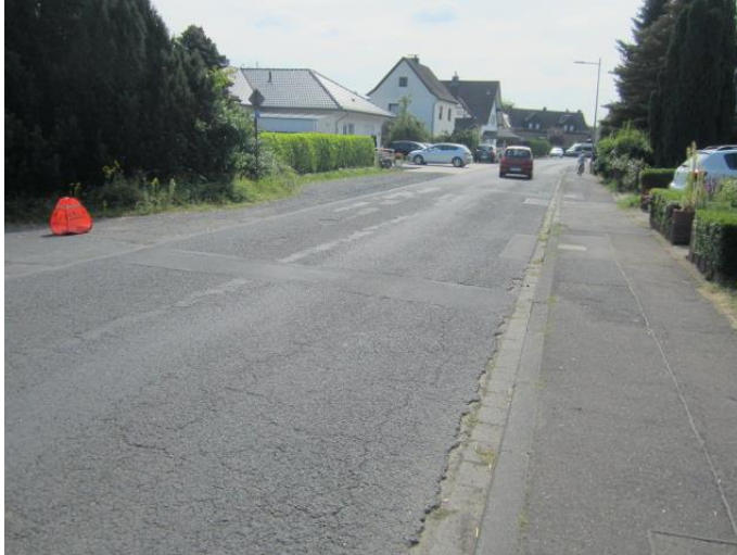
Bild 6: Zustand Gehweg und Fahrbahn
