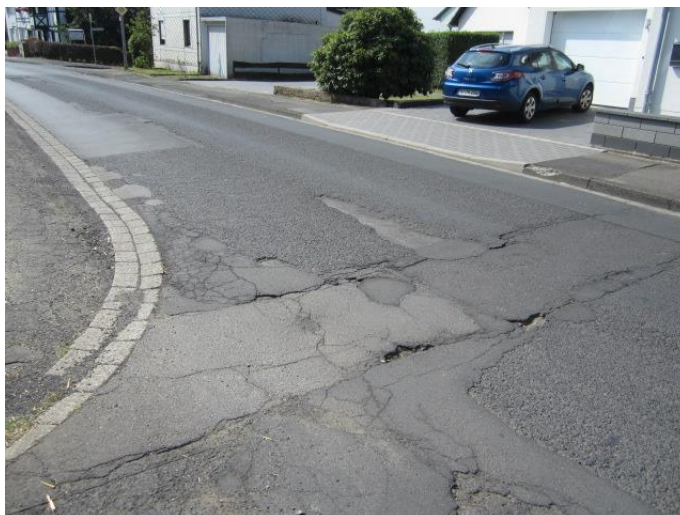
Bild 10: Zustand Gehweg und Fahrbahn
