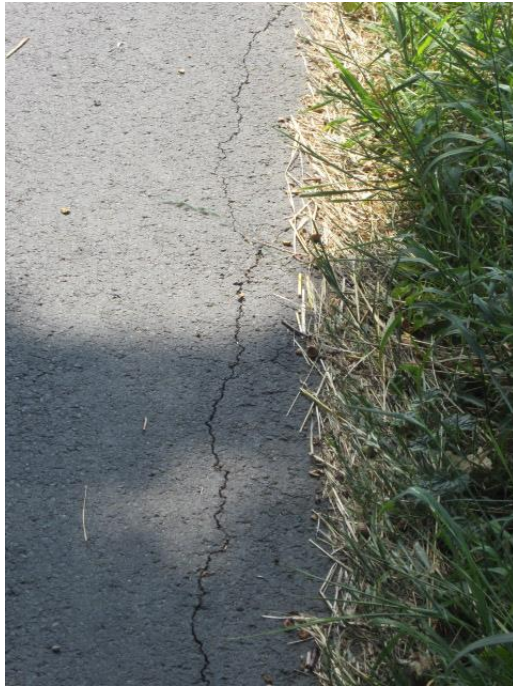
Bild 17: Risse am Fahrbahnrand
