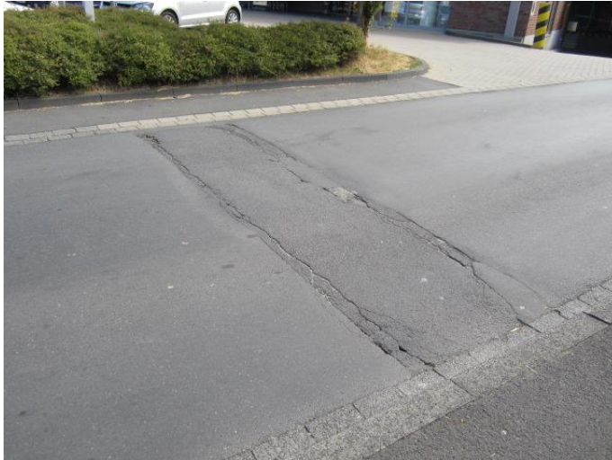
Bild 4 „nicht fachgerechte Straßenaufbrüche“
