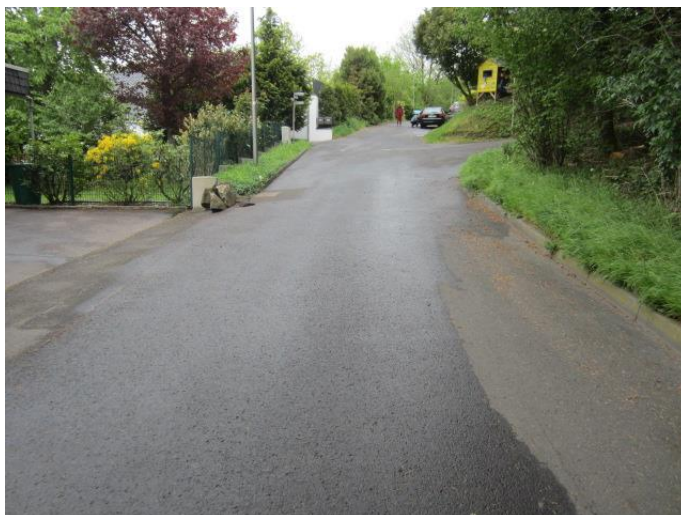
Bild 3: Zustand der Straße
