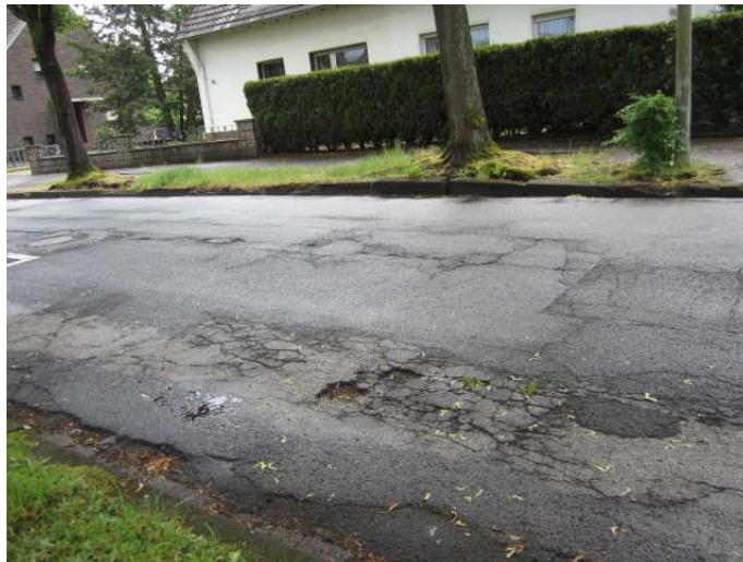
Bild 4: Beispiel schadhafte Fahrbahn und durch Wurzeln gehobene Borde 1
