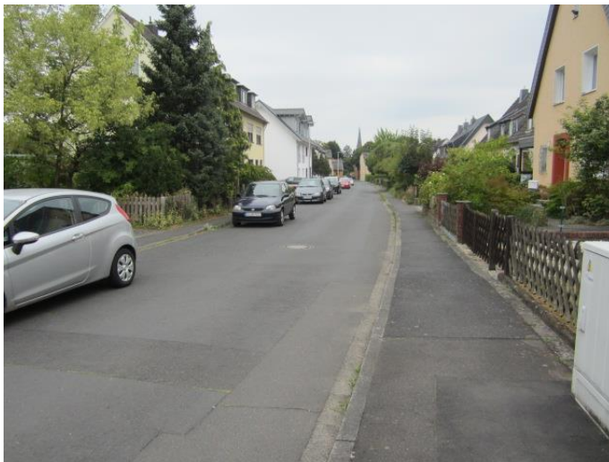
Bild 3: Straßenzustand im östlichen Abschnitt Sandweg
