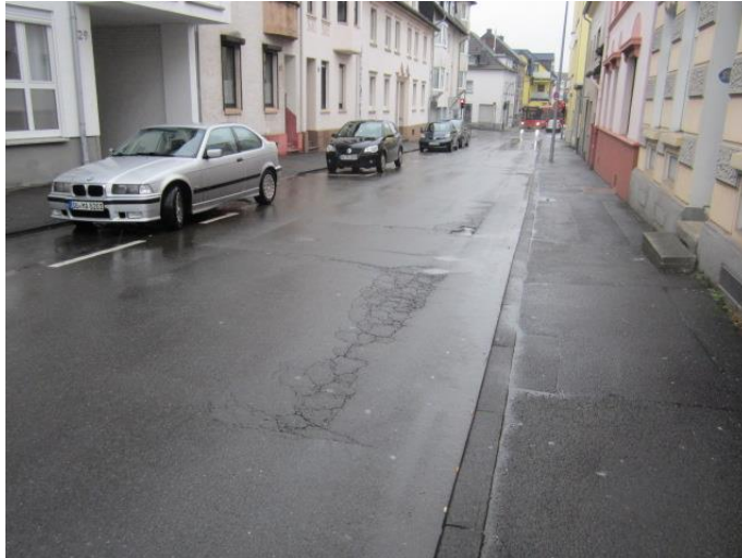
Bild 12: Rissbildung Fahrbahn mit Gehweg
