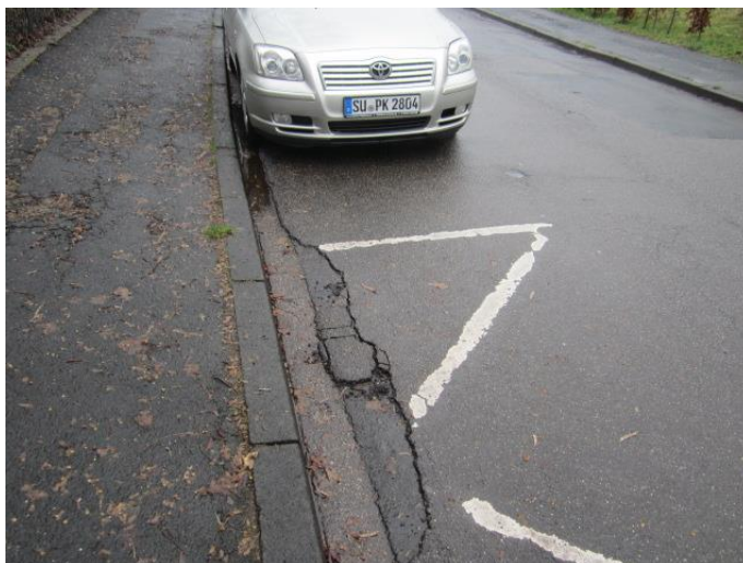
Bild 5: Schadstelle am Rand der Fahrbahn
